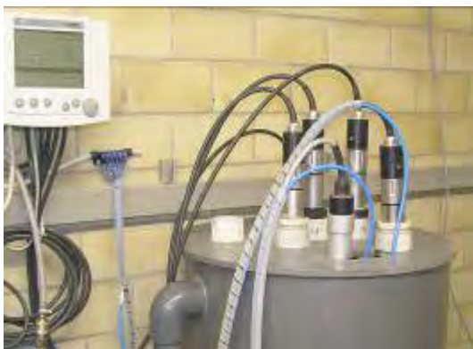
Abb. 3.2.1.-6: Sensoren im Probenwasserstrom
