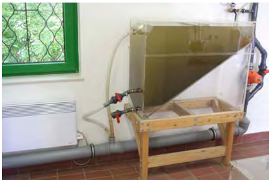
Abb. 3.2.1.-5: Sedimentationsbecken, Messstation Frankfurt (Oder)
