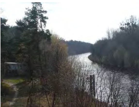
Abb. 3.2.3.-5: Messstation Kleinmachnow am Teltowkanal (Gebäude linke Seite). Neben den mess- und strömungstechnischen Fragen bezüglich des Entnahmepunktes im Gewässer spielen auch Fragen der technischen Betreuung, der zeitlichen und verkehrstechnischen Anbindung eine nicht unwesentliche Rolle.
