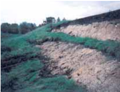
Bild 18: abgerutschte Böschung Oder-Spree-Kanal (1997) bei Eisenhüttenstadt
