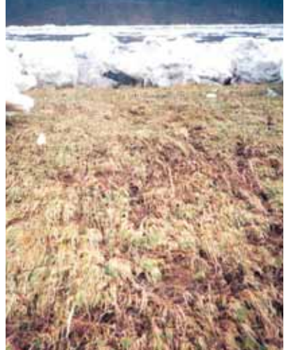
Bild 10: geschädigte Grasnarbe durch Eis und Überströmen Oderdeich Winter 2003
