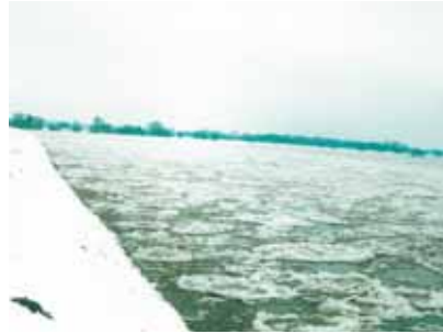
Bild 25: Elbdeich bei Jagel (Jan. 2003) Deichgefährdung durch in der Strömung rotierende Eisschollen, die sich kreissägeartig in die Böschungen einschneiden. Diese horizontalen Einschnitte erreichten innerhalb weniger Stunden die Größenordnung von 3m und die unterhöhlten Bereiche brachen wenig später senkrecht nach.
