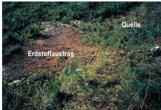
Bild 16: Sickerwasser mit Erdstoffaustrag Oder-Spree-Kanal km 0,8 (1997)
