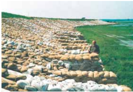
Bild 19: vorbeugende Sicherung des Elbdeiches am „Bösen Ort“ bei Wustrow (August 2002), Stützpfiler aus Sandsäcken
