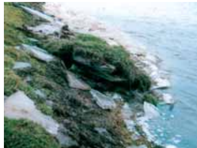
Bild 26: Elbdeich bei Wootz (Jan. 2003) Böschungsschälung durch Eis
