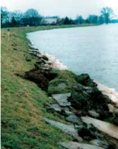
Bild 9: Böschungsschälung durch Eis Elbdeich Winter 2003
